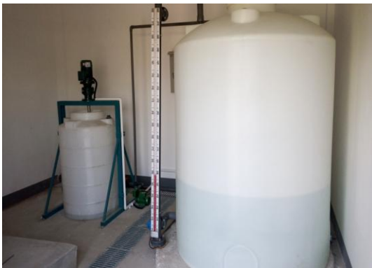
氯酸钠储存间
